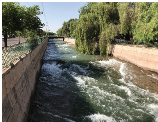
Figura 12. Tramo donde se ve el Zanjón canalizado durante su paso por la ciudad de Mendoza.
